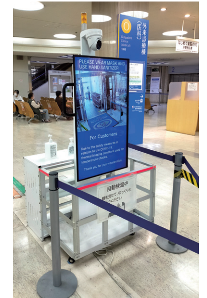
▲サーモグラフィーシステム
